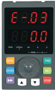
图4-5 故障告警显示状态
